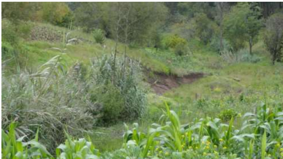
FOTOGRAFÍA NRO. 22: ZONA INESTABLE AL FRENTE DEL DESLIZAMIENTO PRINCIPAL FUENTE: EQUIPO CONSULTOR
