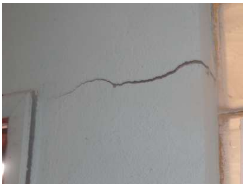
FOTOGRAFÍA NRO. 32: FISURAS EN LA PARED
