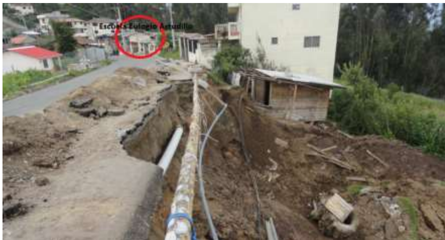
FOTOGRAFÍA NRO. 35: DESLIZAMIENTO TOMADO EN MARZO DE 2012
