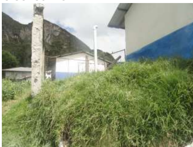
FOTOGRAFÍA NRO. 30: POZO SÉPTICO CERCA AL DESLIZAMIENTO FUENTE: EQUIPO CONSULTOR
