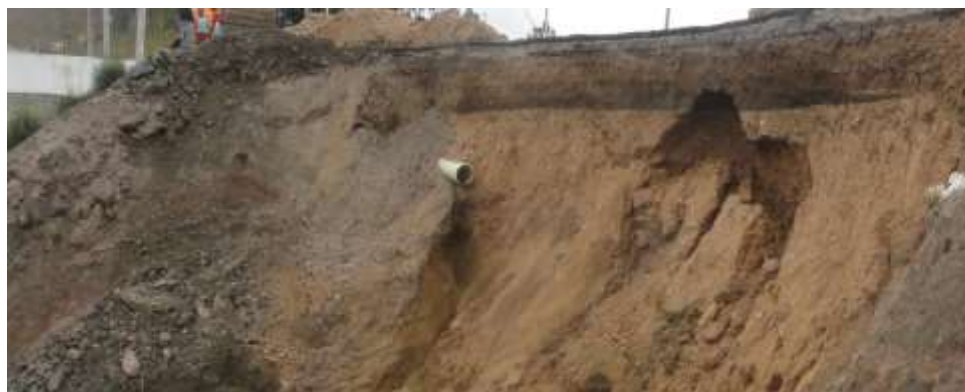
FOTOGRAFÍA NRO. 21: TUBERÍA DEL ALCANTARILLADO COLAPSADA QUE APORTA GRAN CANTIDAD DE AGUA A LA FORMACIÓN.
