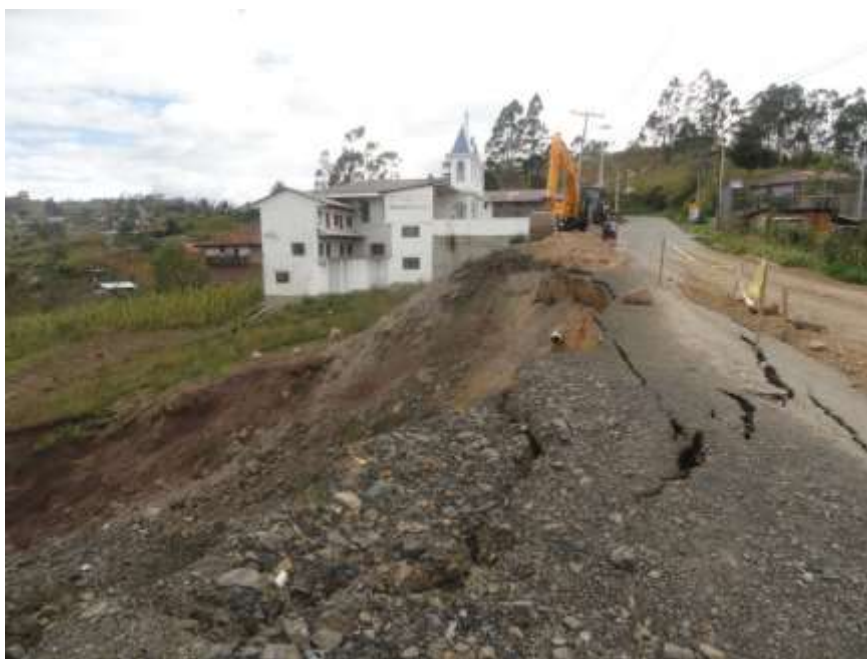
FOTOGRAFÍA NRO. 19: AVANCE DEL DESLIZAMIENTO FUENTE: EQUIPO CONSULTOR ELABORADO POR: EQUIPO CONSULTOR
