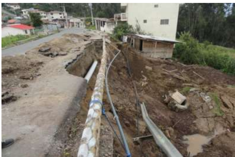
FOTOGRAFÍA NRO. 17: AVANCE DEL DESLIZAMIENTO FUENTE: EQUIPO CONSULTOR ELABORADO POR: EQUIPO CONSULTOR
