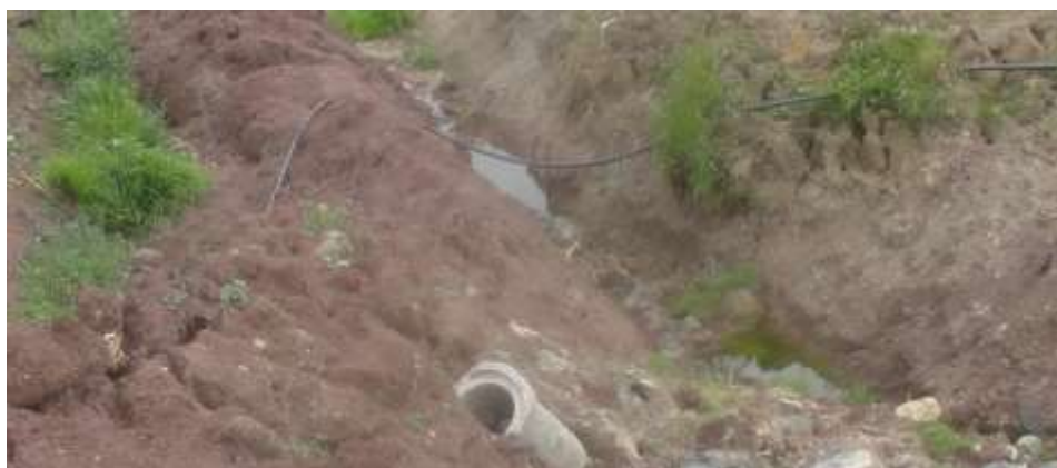
FOTOGRAFÍA NRO. 20: PRESENCIA DE GRAN CANTIDAD DE AGUA AL PIE DEL TALUD
