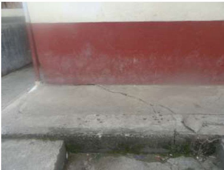
FOTOGRAFÍA NRO. 33: FISURAS EN EL PISO
