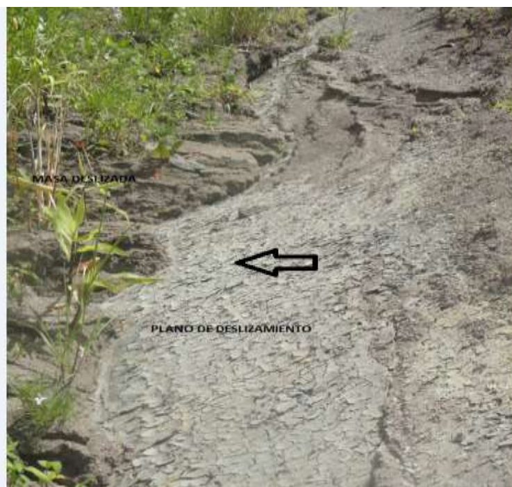
FOTOGRAFÍA NRO. 24: SE PUEDE OBSERVAR UN PLANO DE DESLIZAMIENTO LUBRICADO (HÚMEDO) Y LA MASA DESLIZADA FUENTE: EQUIPO CONSULTOR
