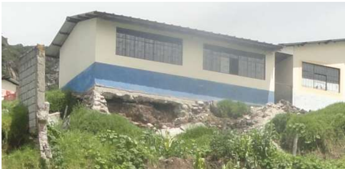
FOTOGRAFÍA NRO. 23: SOCAVAMIENTO DE LOS CIMIENTOS DE LA ESCUELA FUENTE: EQUIPO CONSULTOR
